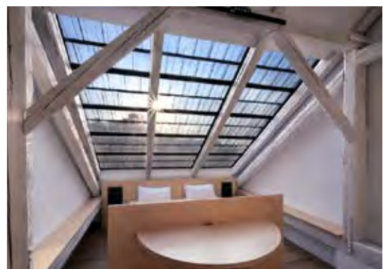
Systém Nebesys v instalaci na hotelu Duo v Mikulově - pohled zevnitř
