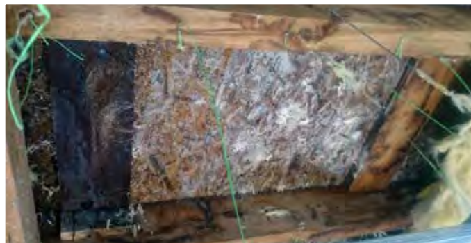
Obr. 2 Pohľad na OSB dosku záklopu kompletne pokrytú hubami a znateľne mokrú stužujúcu fošňu.
