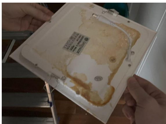
Obr. 4 - Těleso LED osvětlení se stopami vody
