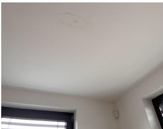
Obr. 3 - Fleky na podhledu
