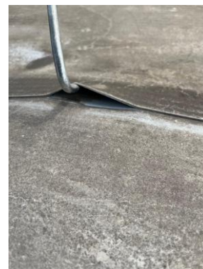
(studený spoj po iskrovej skúške)
