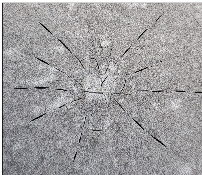
Obr. 1 PVC-P fólie poškozená krupobitím, Zdroj: Vlastní
